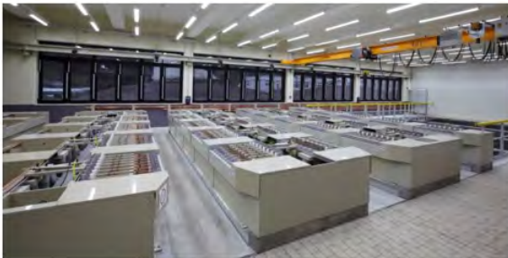
Bild 1: Elektrolysezellen im Refining
