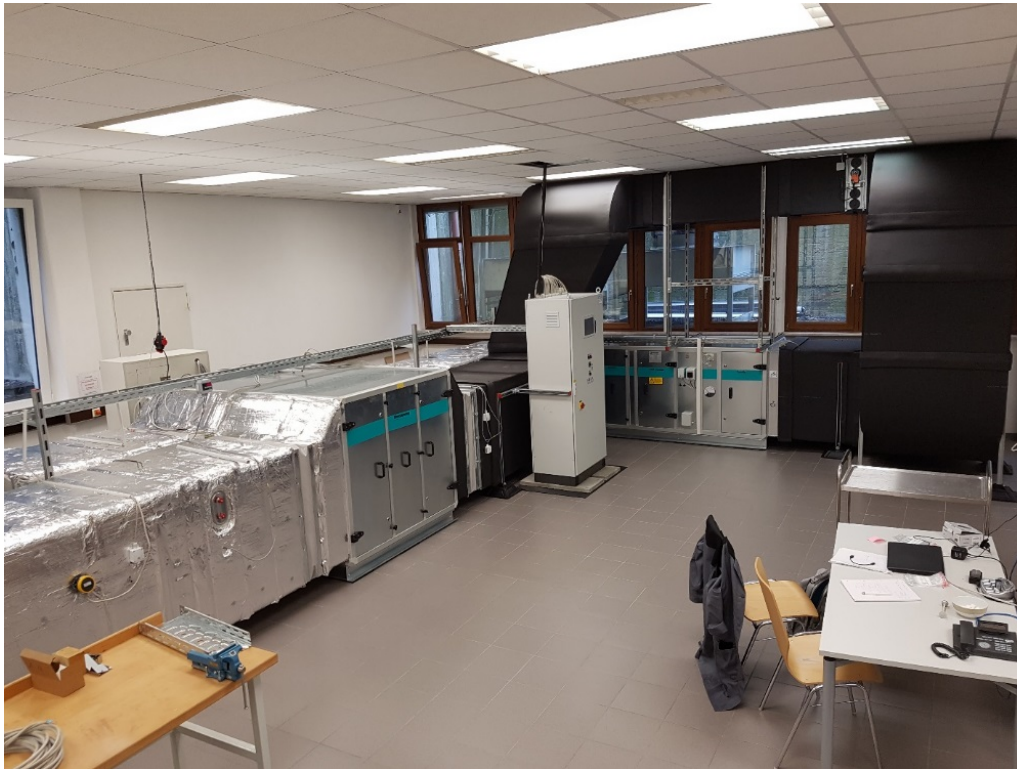
Versuchsanlage Regenerativwärmeübertrager im Laborraum des Innotecgebäudes
